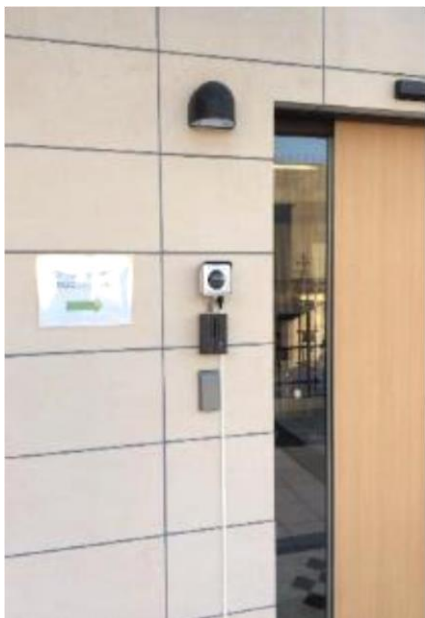
入口に設置したカメラ
