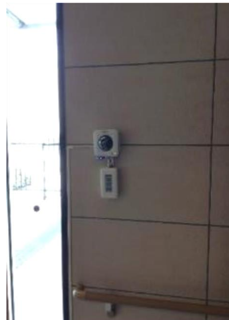
出口に設置したカメラ
